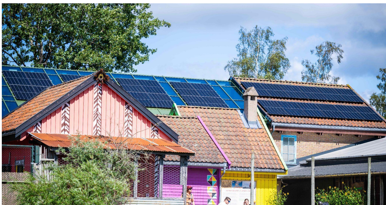
Solcelleanlegg på Terrariet.
